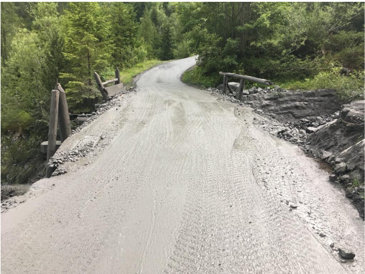
Wiederinstandstellung der Rinderstutzbrücke. Solche Ereignisse (Lawinen oder Murgänge) fanden früher auch statt, jedoch höchstens alle 5 bis 7 Jahre.
