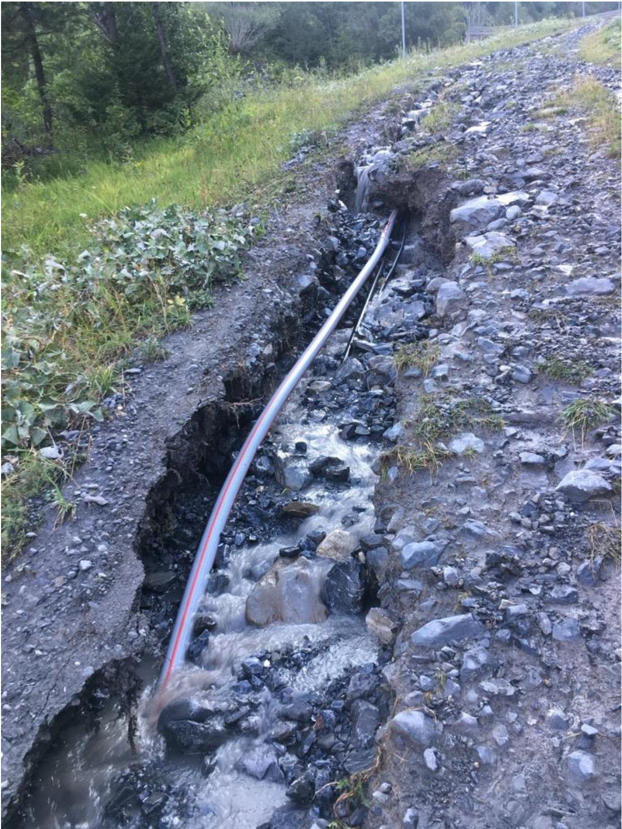
Das Wasser frisst die Leitungen aus (August 2018).
