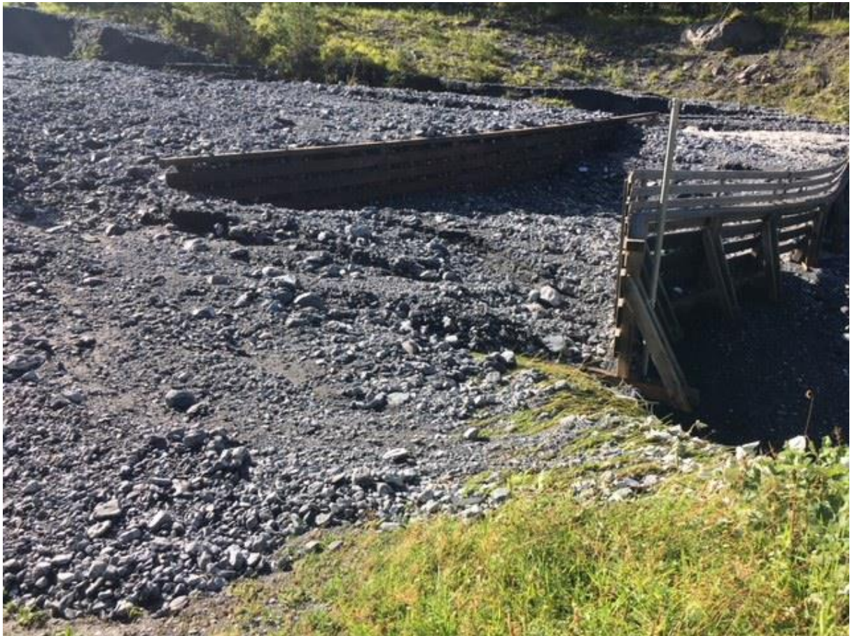
Die Brücke wurde seitlich von den Geröllmassen weggedrückt.
