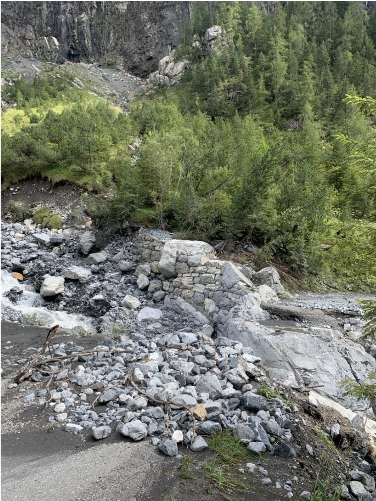
Standort alte Rinderstutzbrücke (welche nach dem Ereignis im Sommer 2019 nicht mehr ersetzt wurde).
