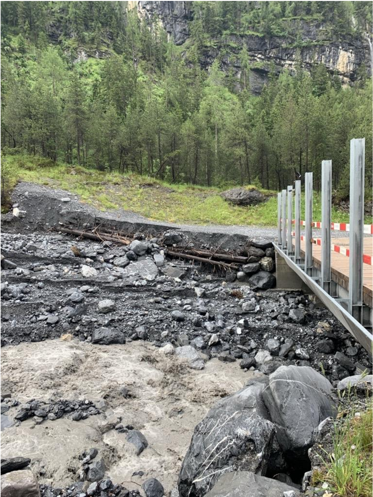
Seitliche Fundamente der Skibrücke werden angefressen. Die eingelegten Tannen zur Stabilisierung der Böschung sind freigelegt.
