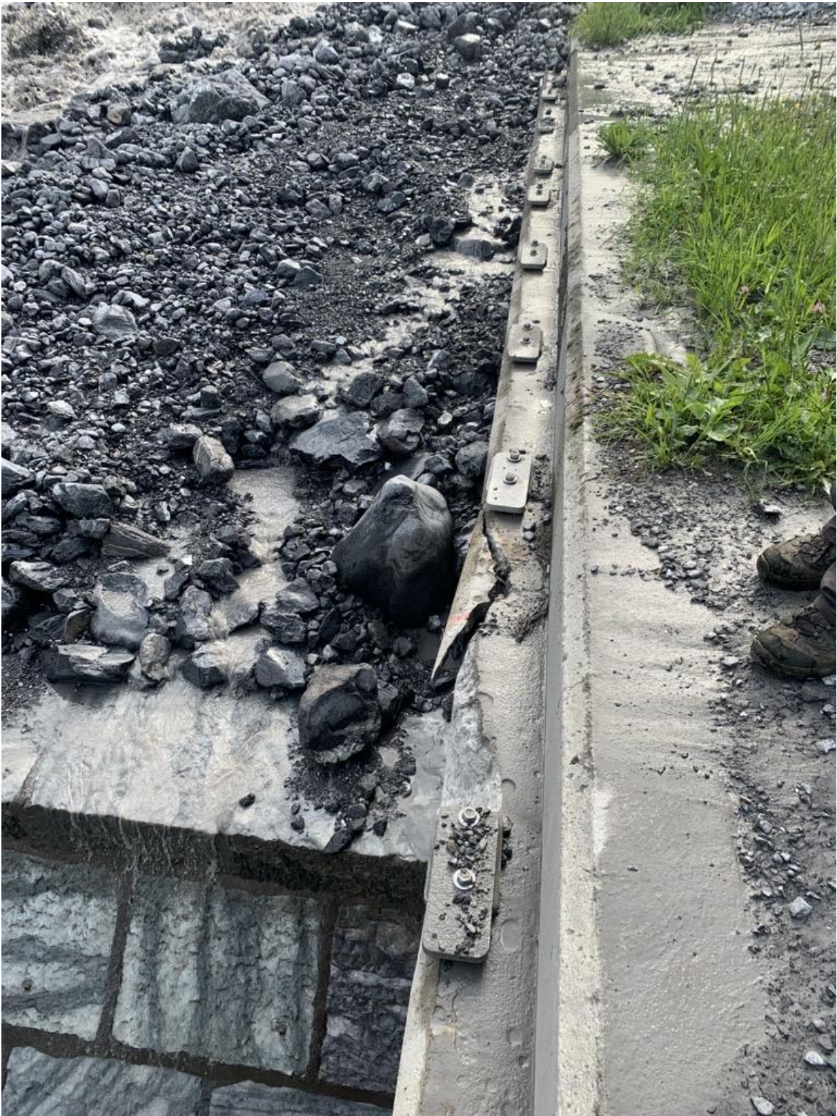
Beschädigte Fundamente der unteren Skibrücke / Tyroler Wehr.
