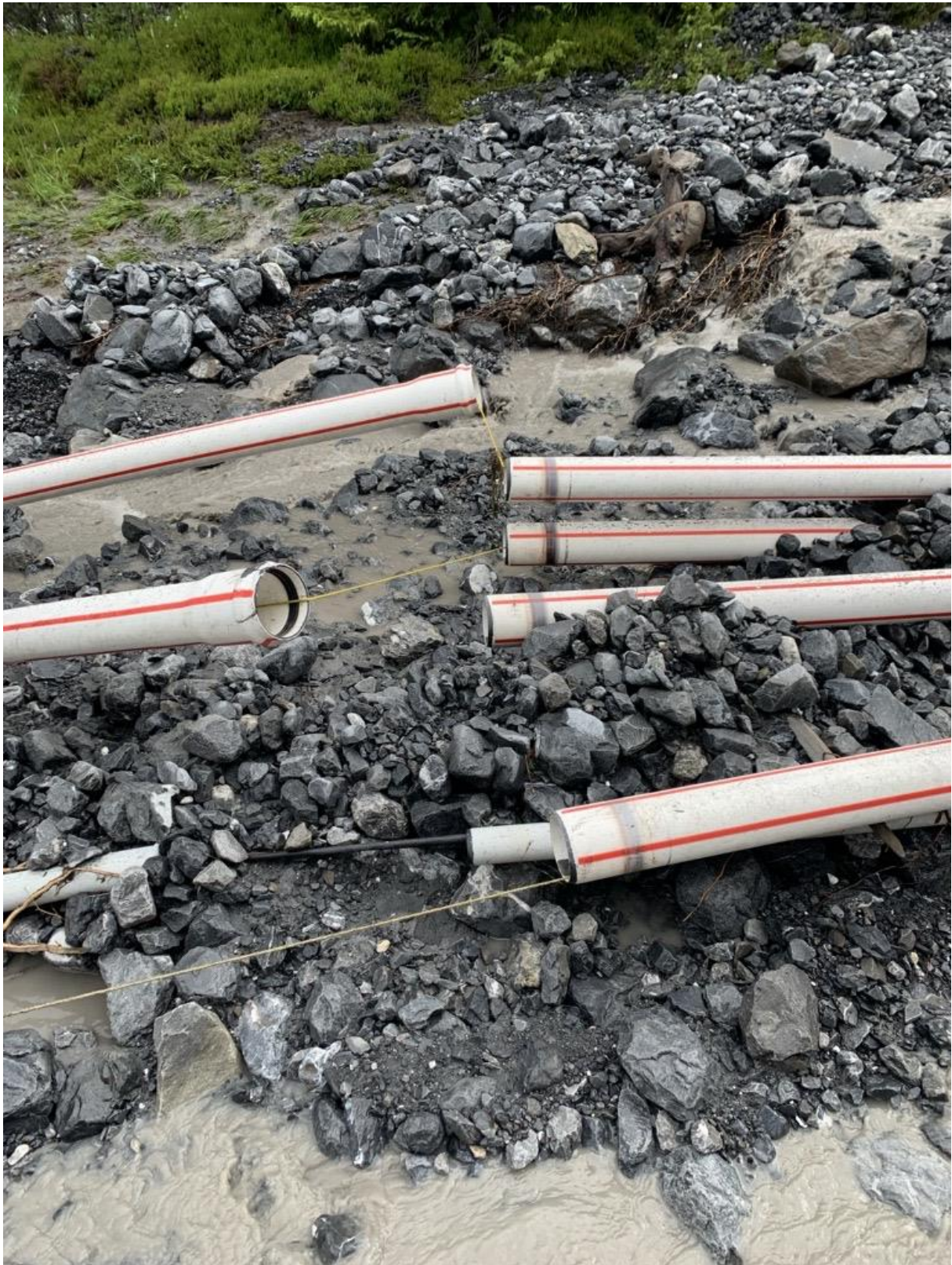
Ein weiterer Murgang / Unwetter hat die Leitungen zwischen der Transportbahn Doldenhornhütte und Tyroler Wehr freigelegt.
