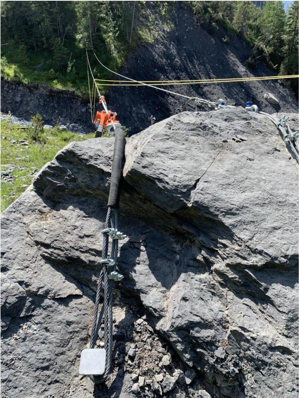
Installation Pegelradar Nummer 1 im Chalberspissi-Graben (Pegelradar Nummer 2 ab Sommer 2023).
